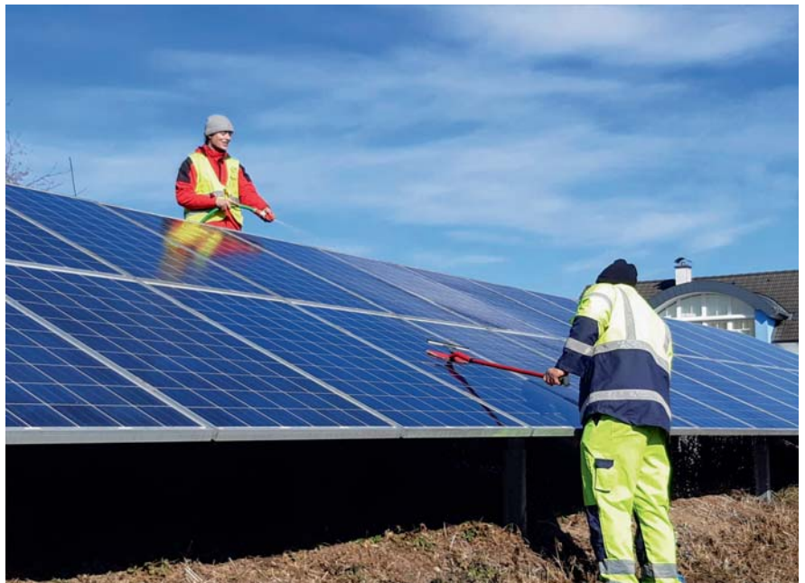
Foto: Reinigung der Photovoltaikanlage beim Wasserwerk
